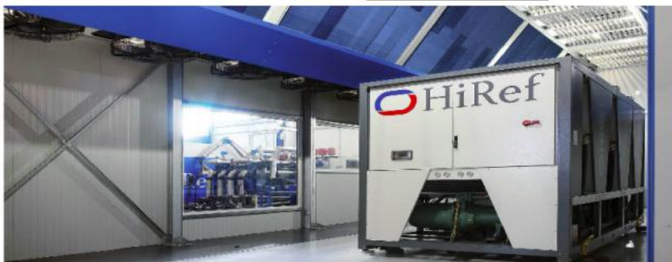
Eine Anlage von HiRef: Kühlsystem
